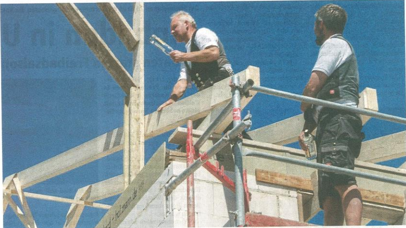
Kein Richtfest ohne Richtspruch: Bei strahlendem Sonnenschein zerschlugen die Zimmerer die Flasche auf dem Dachbalken. Fotos: Klaus-Dieter Plage
