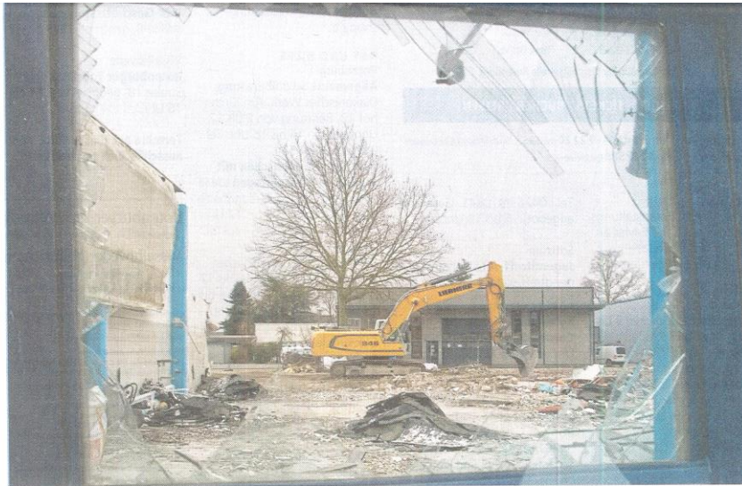
Abriss: Die alte Wäscherei auf dem Gelände der Werke ist Geschichte. Es gibt Platz für Neues.
